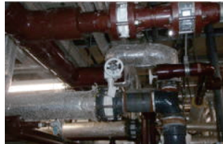
補給水昇温配管
